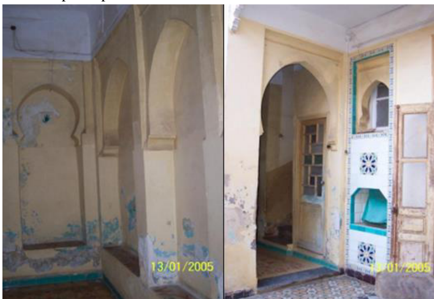
Fig2 : le vestibule d’une maison traditionnelle à Derba Hlawa, médina de Tlemcen -a- Dekkanet-b-l’entrée en chicane (Didi 2013)
