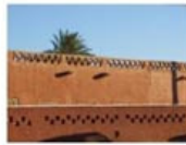
Choriffs et appareillages de briques de terre formant frise de claustras ( partie restante de l'école des filles sur façade arrière ouest de la Place des Martyrs)
