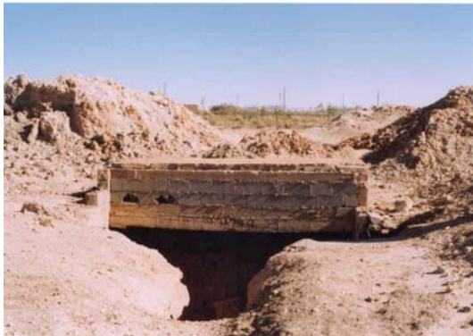
Photo n° 24 .- Vue de la bache d'eau détruite
